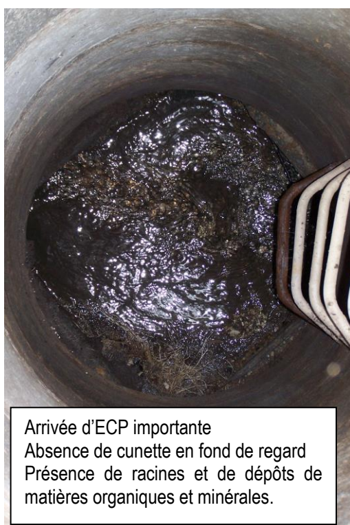
Photo n°6 : Regard amont step
