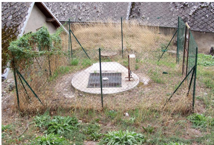
Photo n°4 : Station d'épuration du lotissement HLM « Sous Belle Roche »
