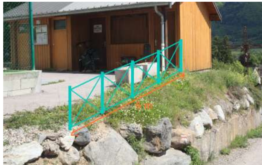
Sécurisation des abords du chalet de tennis
