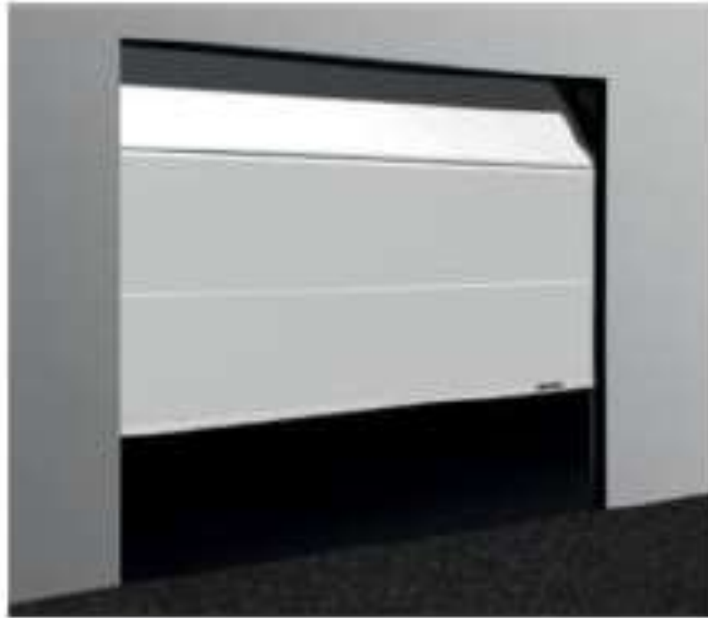
Porte atelier communal cassée
