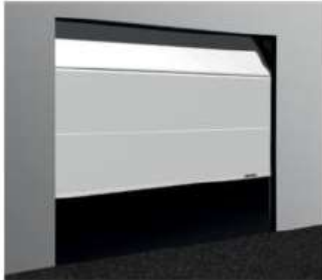
Porte atelier communal cassée
