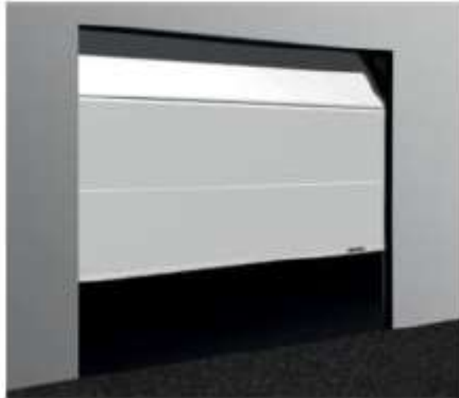
Porte atelier communal cassée
