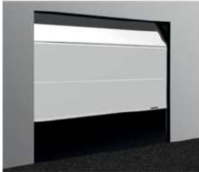
Porte atelier communal cassée
